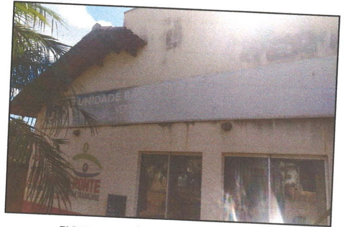
FIGURA 02 - Área externa danificada
