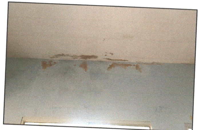
FIGURA 04 - Manchas na parede
