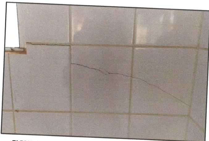
FIGURA 03 - Revestimento cerâmico danificado
