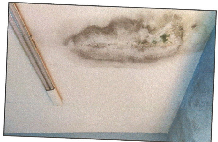
FIGURA 06 - Manchas no teto
